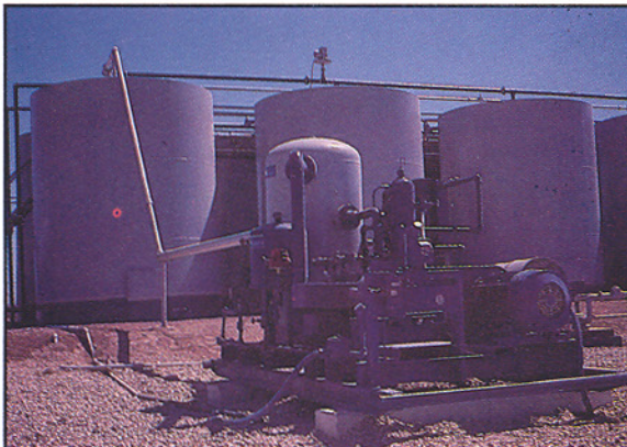
天然氣蒸氣回收系統
